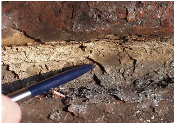
10mm Котельная накипь
